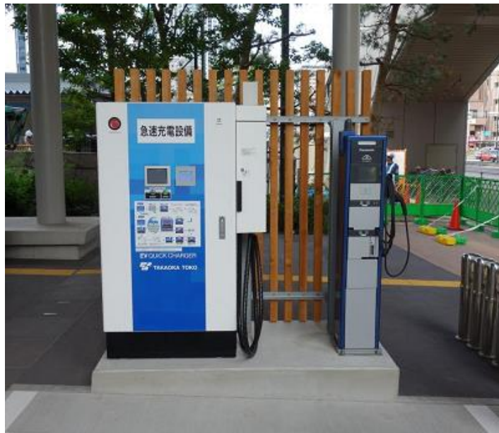
EV充電設備 出典:江東区HP
