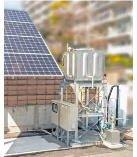
本社敷地内に設置されたタンデム式ソーラーポンプシステム。太陽が出ないときや夜間は手押しポンプにより地下水を汲み上げることが可能。
