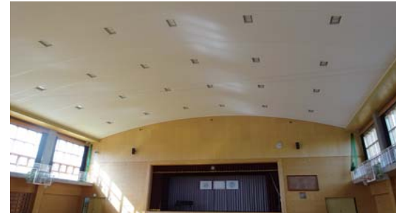
不燃シートによる膜天井
